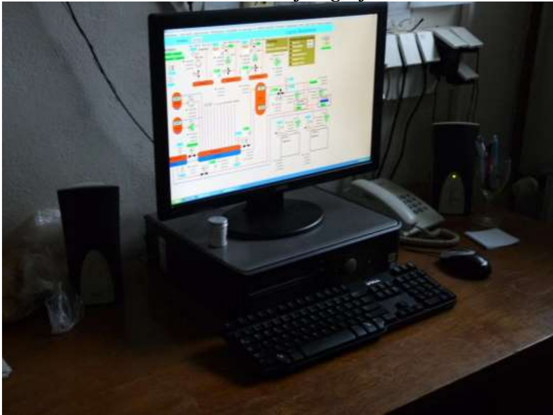
počítač ve strojovně
