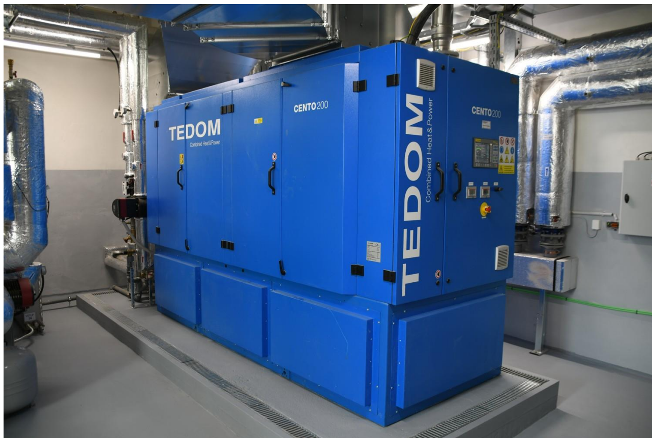
kogenerační jednotka na CZT Boskovice střed
