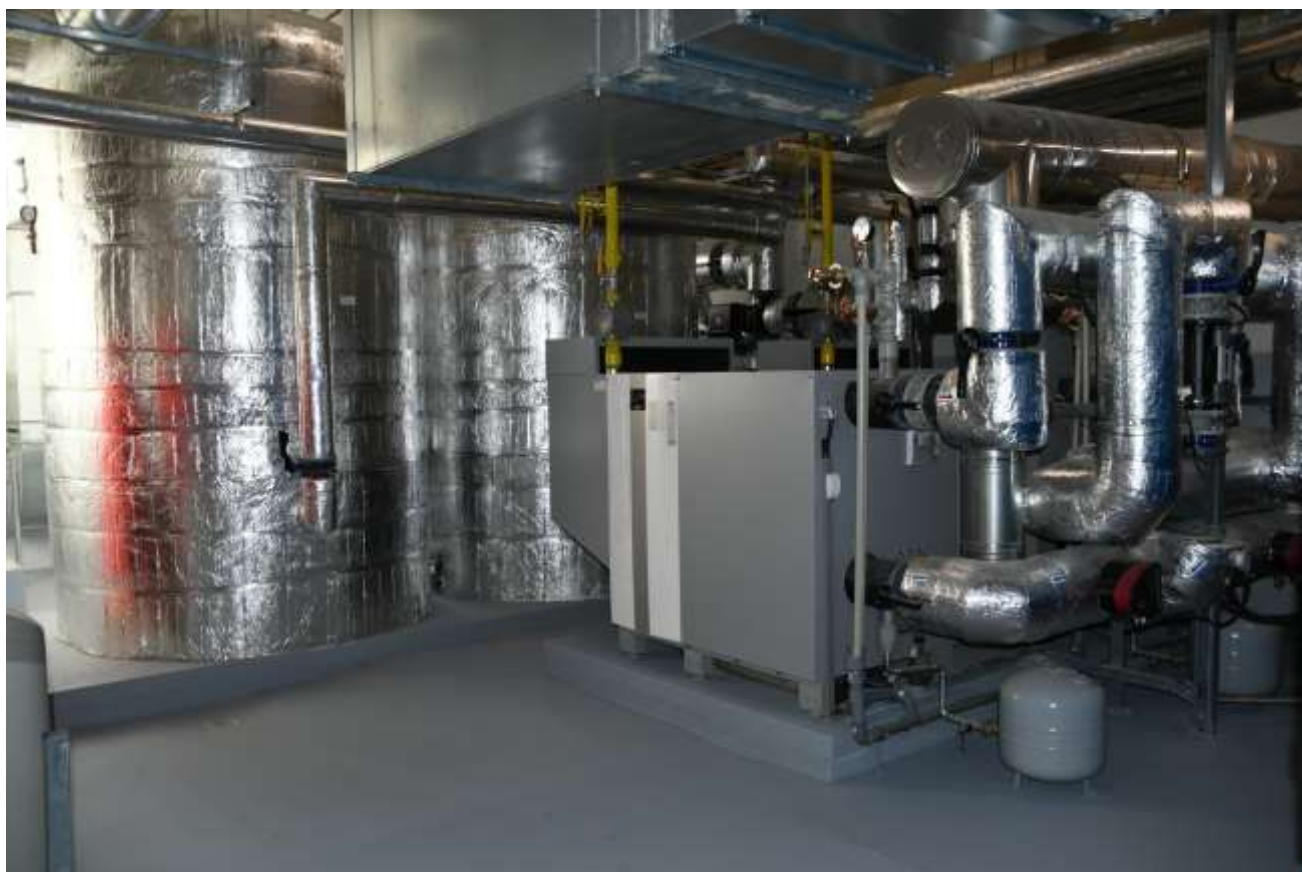
kotle Wolf a akumulční nádoby
