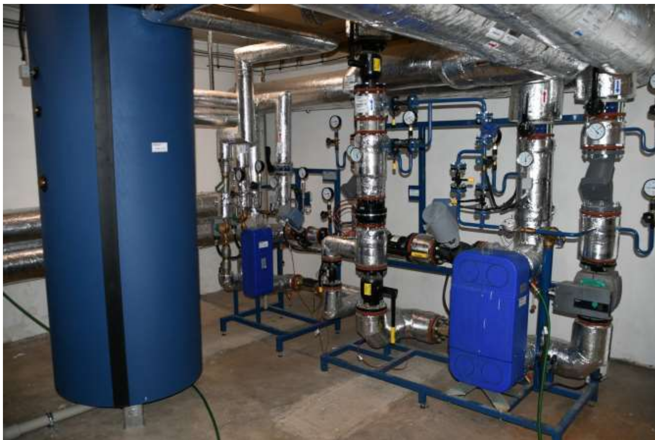
objektová předávací stanice (OPS)
