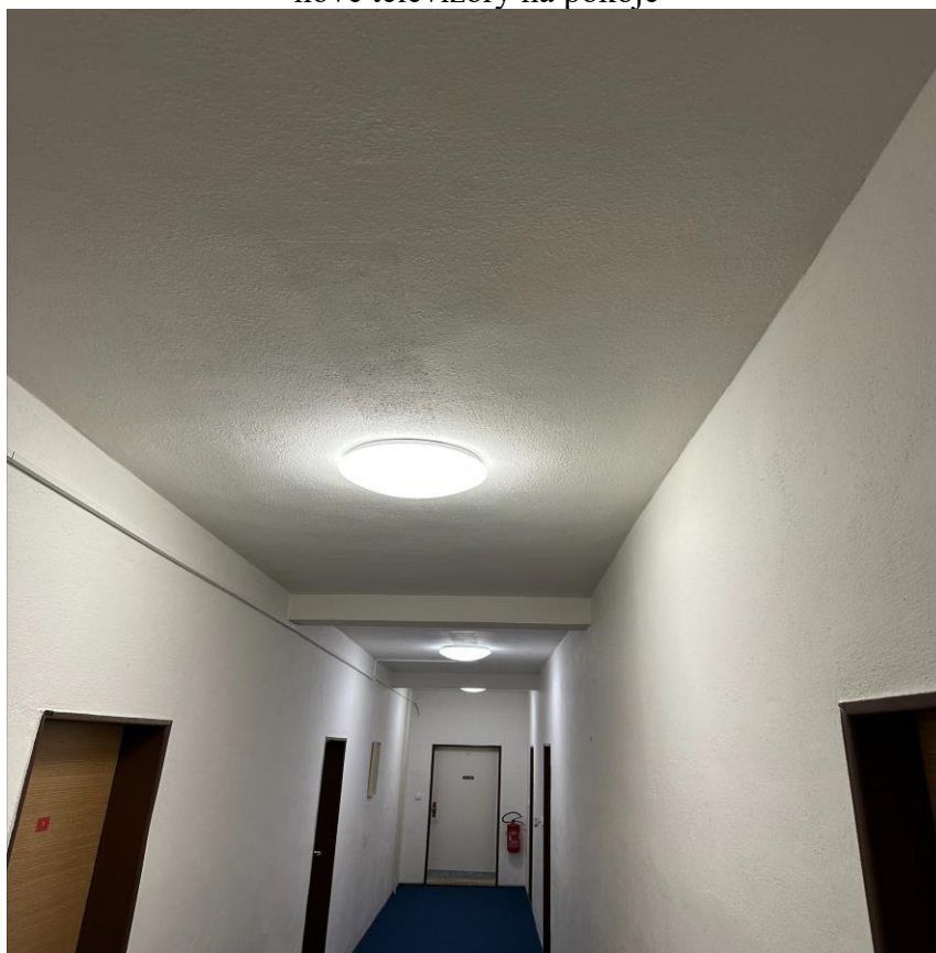
vyměněná svítidla na chodbách
